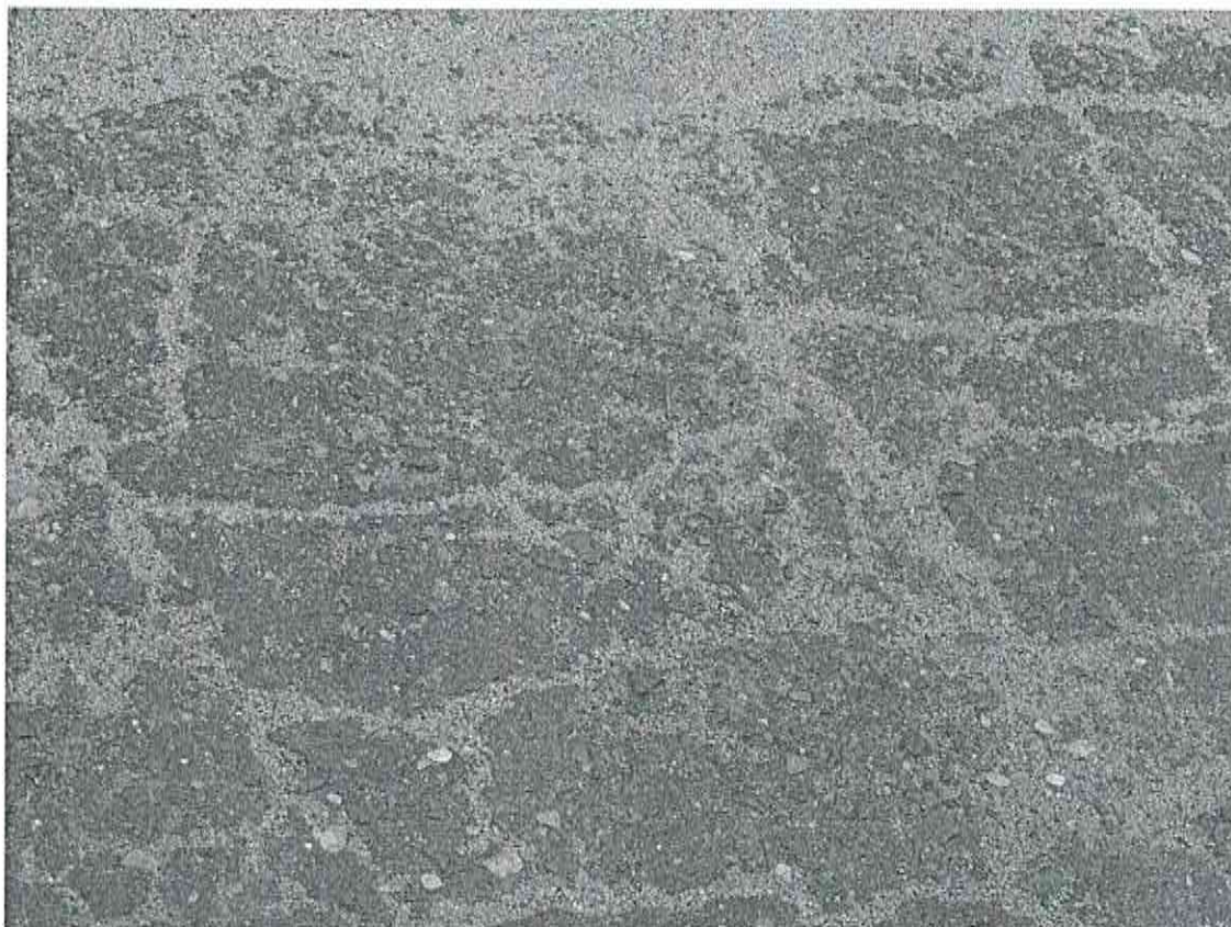
Fot. 3 Nawierzchnia na obiekcie Widoczne spękania nawierzchni bitumicznej.
