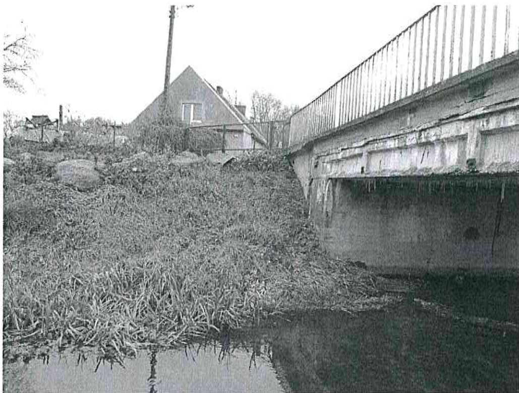
Fot. 10. Skarpa przy skrzydle Brak wzmocnienia i zabezpieczenia skarp.
