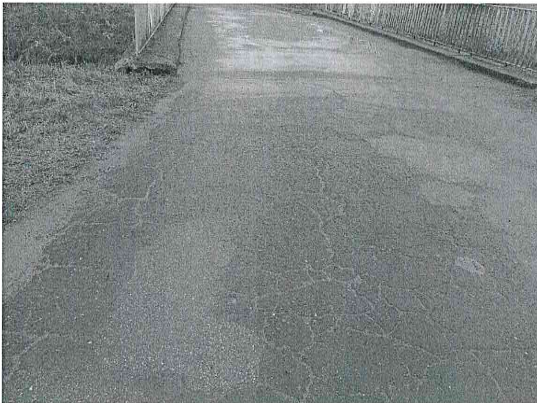
Fot. 4 Nawierzchnia na obiekcie Widoczne deformacje i spękania nawierzchni bitumicznej na obiekcie i dojeździe do niego.
