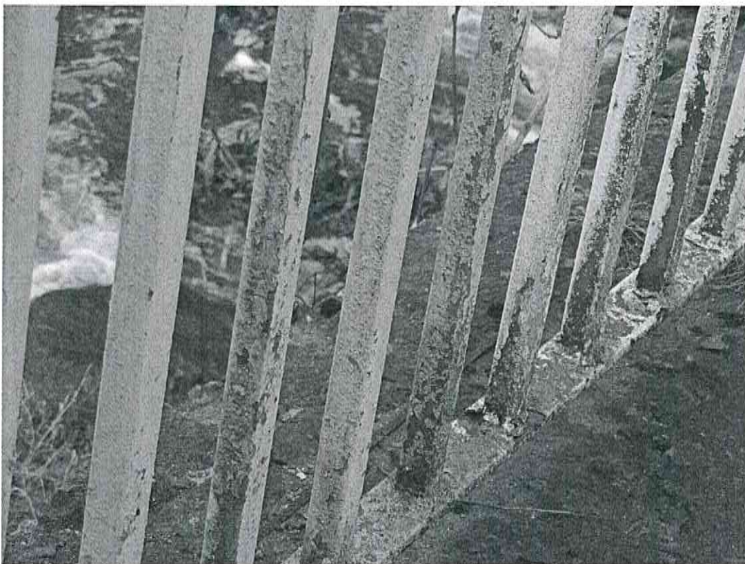
Fot. 5 Balustrada na obiekcie Liczne ogniska korozji, uszkodzenia mechaniczne balustrady.
