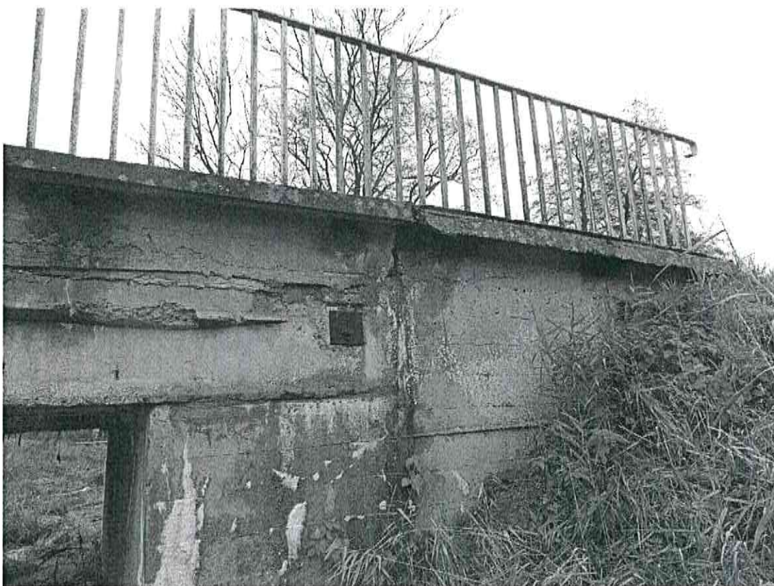
Fot. 11. Przyciótek obiektu Nacieki wapienne, pęknięcia i odspojenia betonu.
