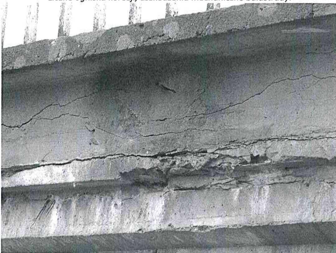
Fot. 6 Powierzchnia boczna ustroju nośnego Ubytki betonu na powierzchni bocznej kapy chodnikowej, pęknięcia i zarysowania na płycie oraz belkach prefabrykowanych. Mokre zacieki oraz nacieki wapienne na wszystkich elementach. Pęknięcia i odspojenia (odsłonięte zbrojenia).
